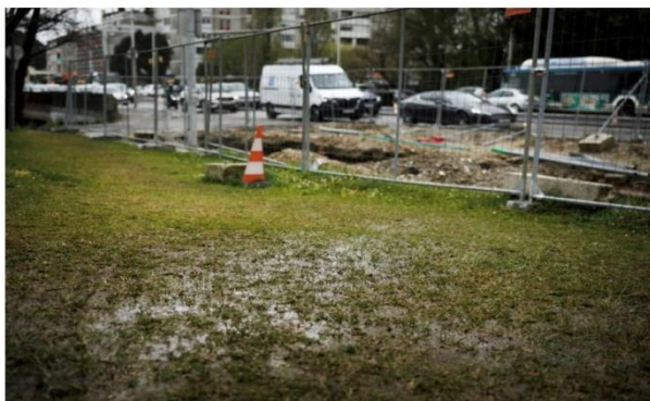
Foto 6 - Estado, com chuva, do percurso utilizado pelos peões face à inexistência de passeio no sentido ascendente da Avenida da Boavista, após a Rua Domingos Alvarez (28 março 2024).
