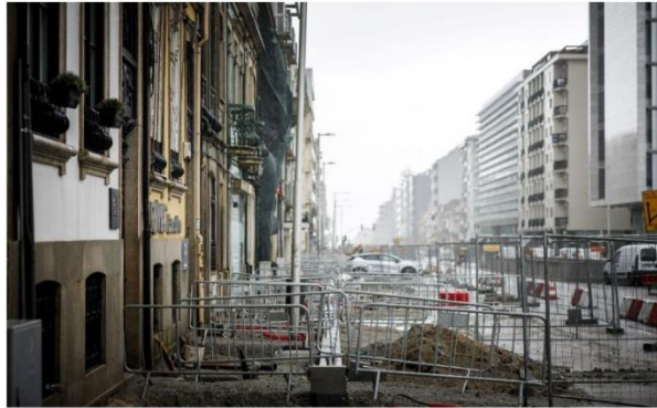
Foto 7 - Panorâmica da intervenção no sentido ascendente da Avenida da Boavista em frente à Casa da Música (28 março 2024).
