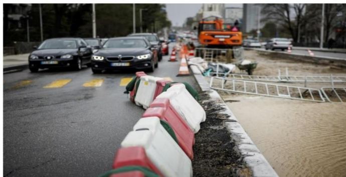
Foto 21 - Barreiras delimitadoras de espaço que se movimentaram, invadindo a faixa de rodagem e impedindo a circulação de duas viaturas em paralelo (sentido descendente da Avenida da Boavista) (28 março 2024).
