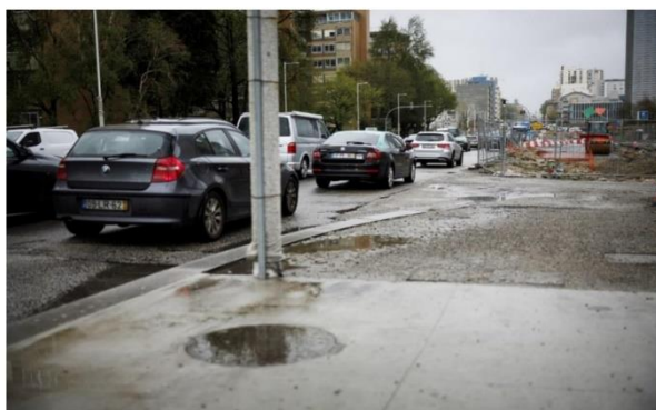
Foto 4 - Término de passeio, sem continuidade, no sentido ascendente da Avenida da Boavista, antes da Rua Domingos Alvarez (28 março 2024).
