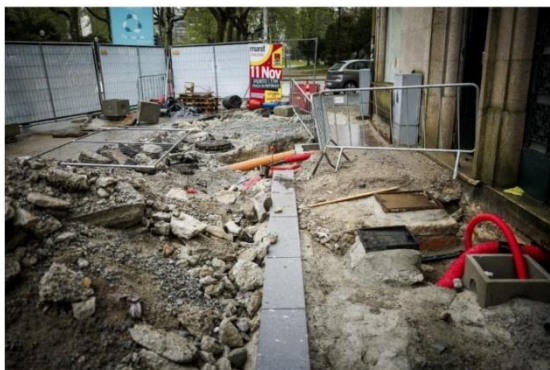
Foto 11 - Acesso provisório a um edifício comercial e de serviços na Avenida da Boavista (28 março 2024).
